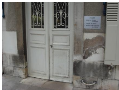
Largeur porte insuffisante
