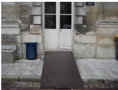
Rampe non conforme Rampe de 11,3% sur 2,70m, absence de palier de repos
